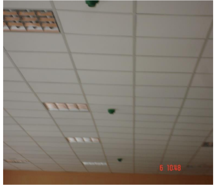
Tavan Aydınlatma ve Yangın Dedektörleri
