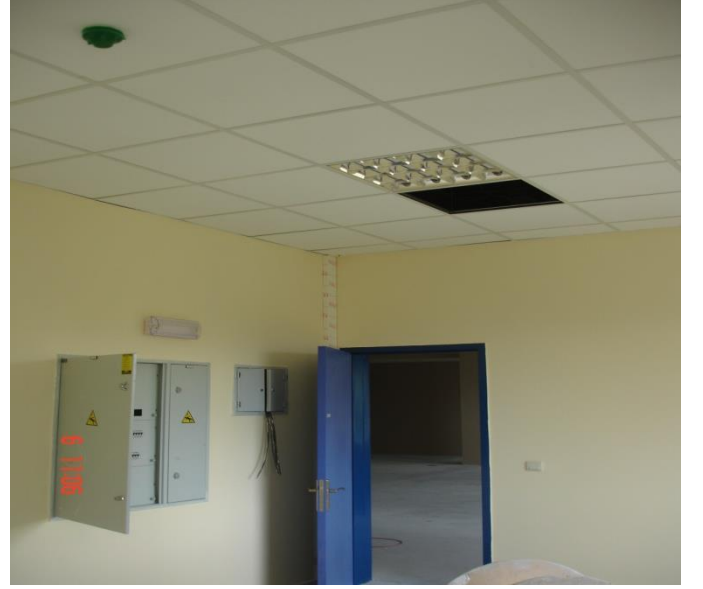
Kat Dağıtım Panosu ve Aydınlatma
