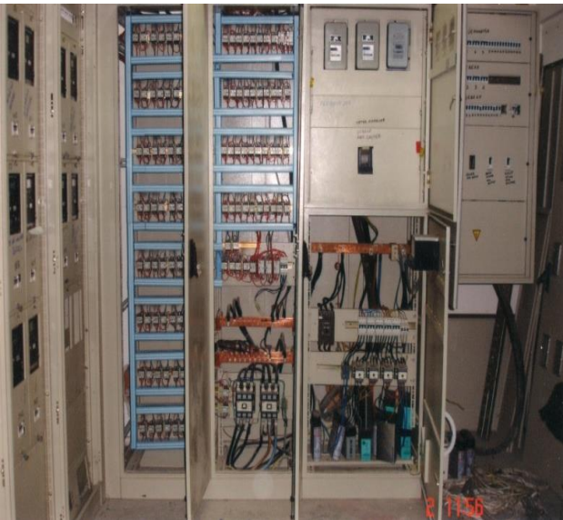
Jeneratör Transfer Panosu iç Görünümü
