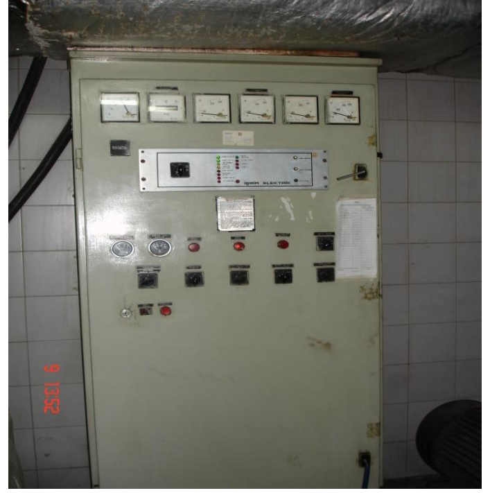
Jenaratör Transfer Panosu
