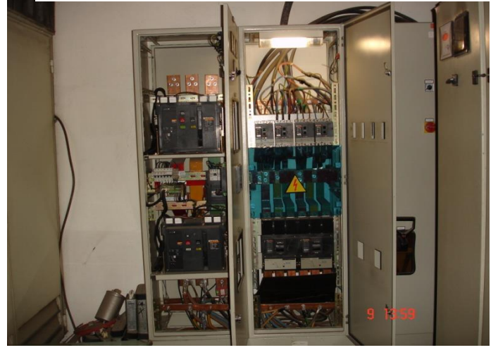
Jenaratör ve Şebeke Panosu İç Görünüm
