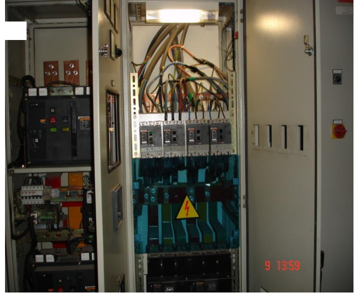
Jeneratör ve Şebeke Panosu İç Görünümü
