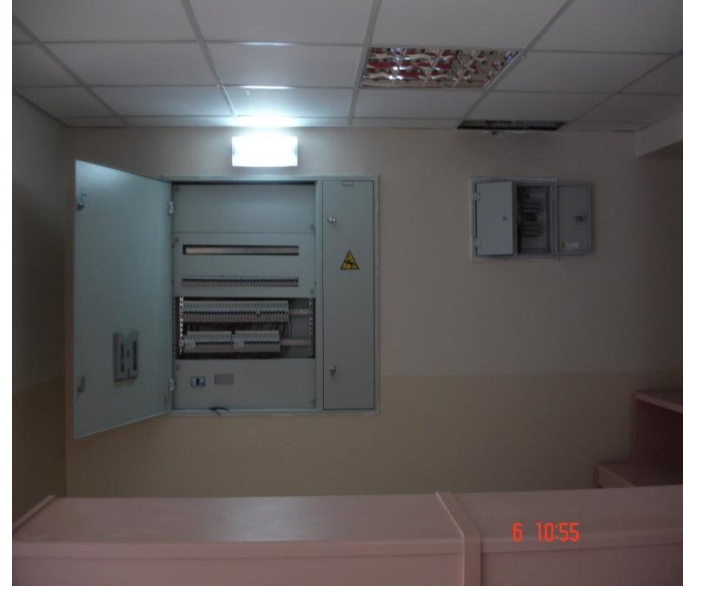
Kat Dağıtım Panosu
